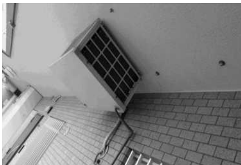
ダイカンプラザ共用通路室外機
